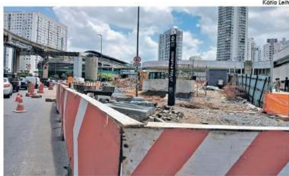
Obra bloqueia o recuo utilizado para embarque e desembarque de pessoas em frente à estação
