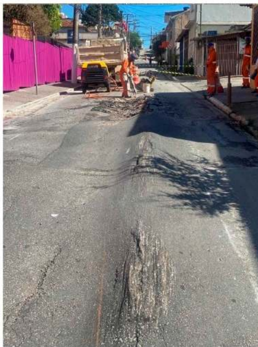
Há mais de um ano, asfalto deformado na Falchi Gianini
