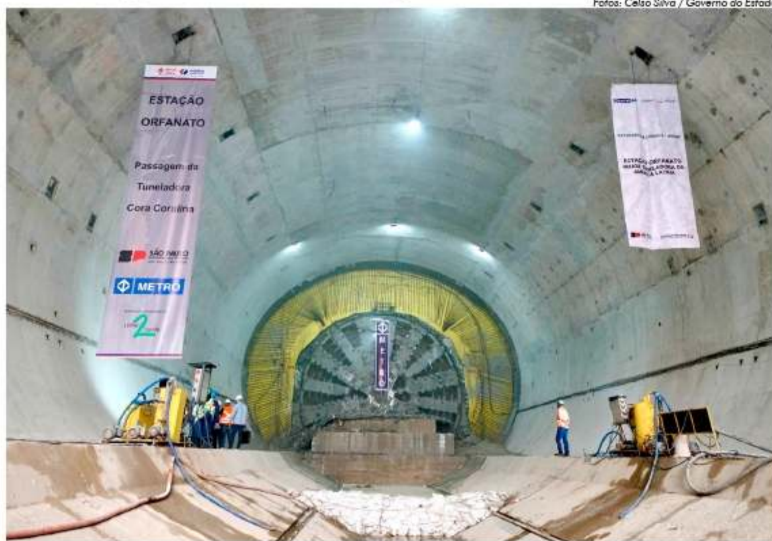
Tuneladora chegou ao canteiro de obras na manhã da última segunda-feira, dia 24
