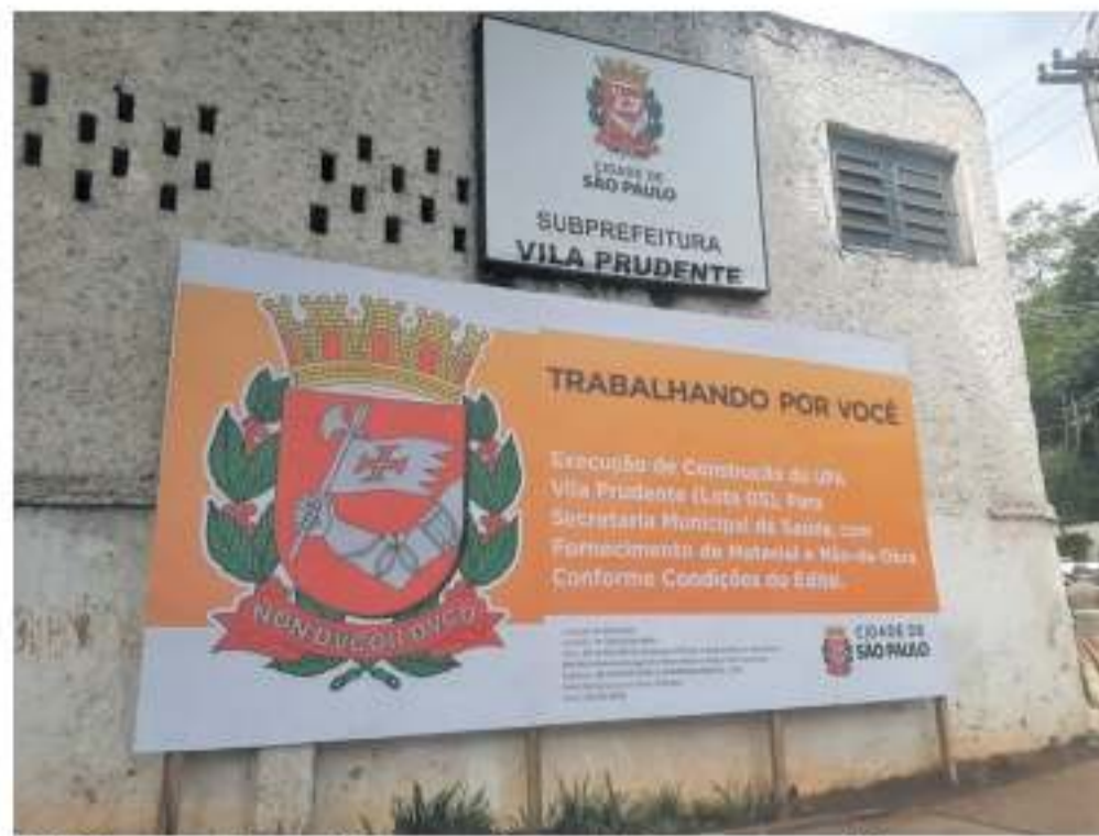
Unidade de saúde está sendo construída na esquina das avenidas Oratório e Alberto Ramos
