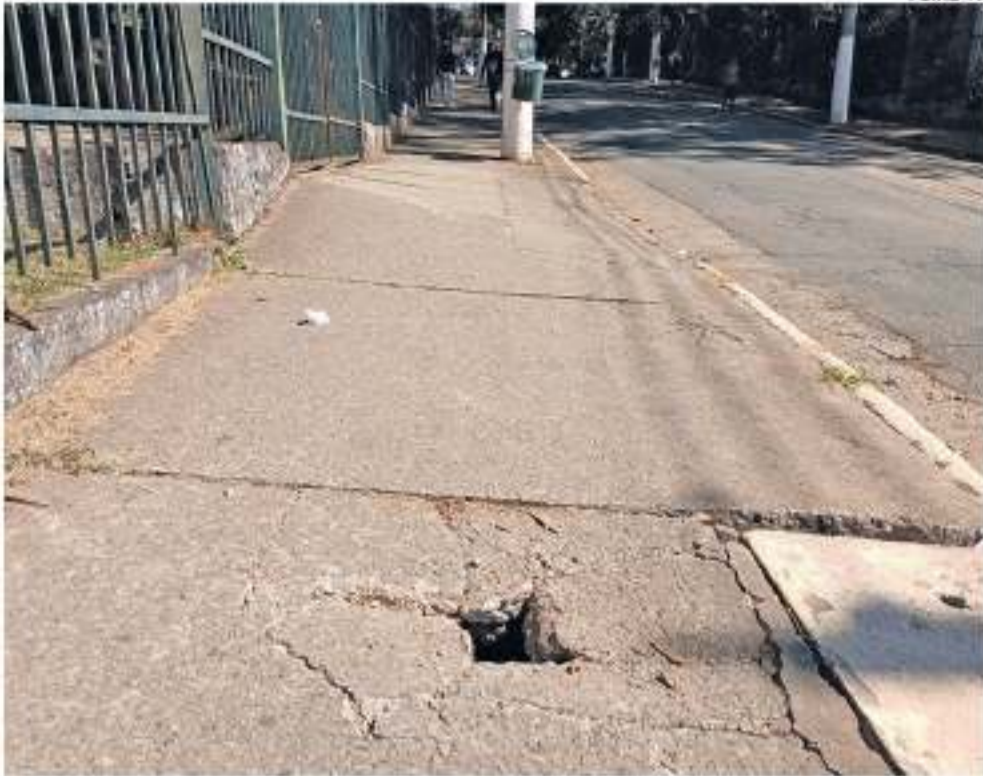
Buraco surgiu no passeio da rua João Pedro Lécór
