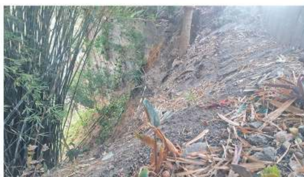
Moradores das Gilias temem foco de erosão na encosta
