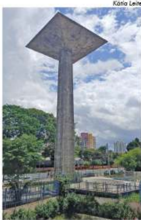
Enorme reservatório continua com graves danos estruturais
